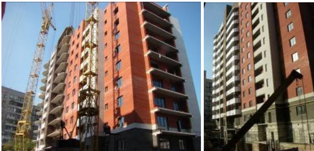
Хід робіт на об'єкті будівництва по вул. Херсонській, у районі буд. № 9 А, станом на травень 2008 року та на кінець листопада 2008 року
