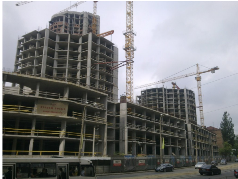
Рисунок 2. Будівельні роботи на об'єкті будівництва офісно-житлового комплексу в м. Києві на ділянці, обмеженої вулицями Глибочицькою, Студентською та Пимоненка станом на червень 2010 р.
