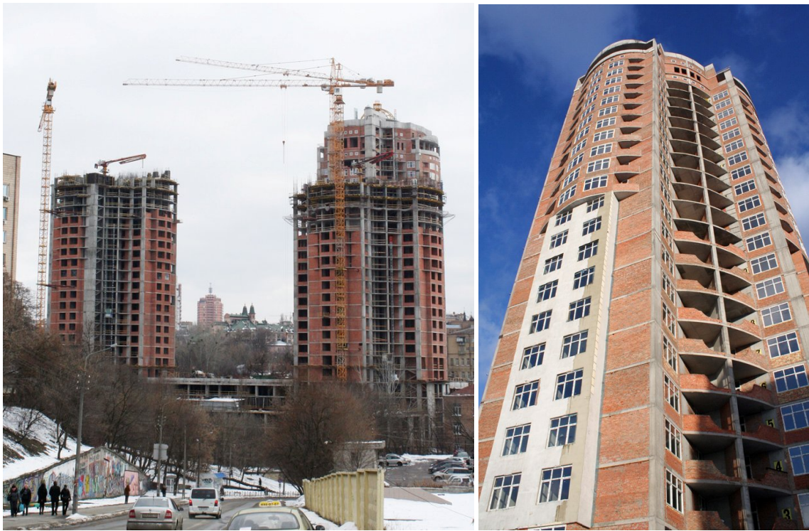
Будівельні роботи на об'єкті будівництва офісно-житлового комплексу в м. Києві на ділянці, обмеженої вулицями Глибочицькою, Студентською та Пимоненка станом на лютий 2012 року
