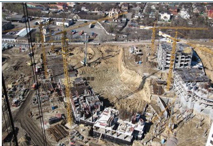
Хід будівництва II черги житлового кварталу з об'єктами соціально-громадського призначення по вул. Професора Підвисоцького у Печерському районі м. Києва станом на початок квітня 2012 року
