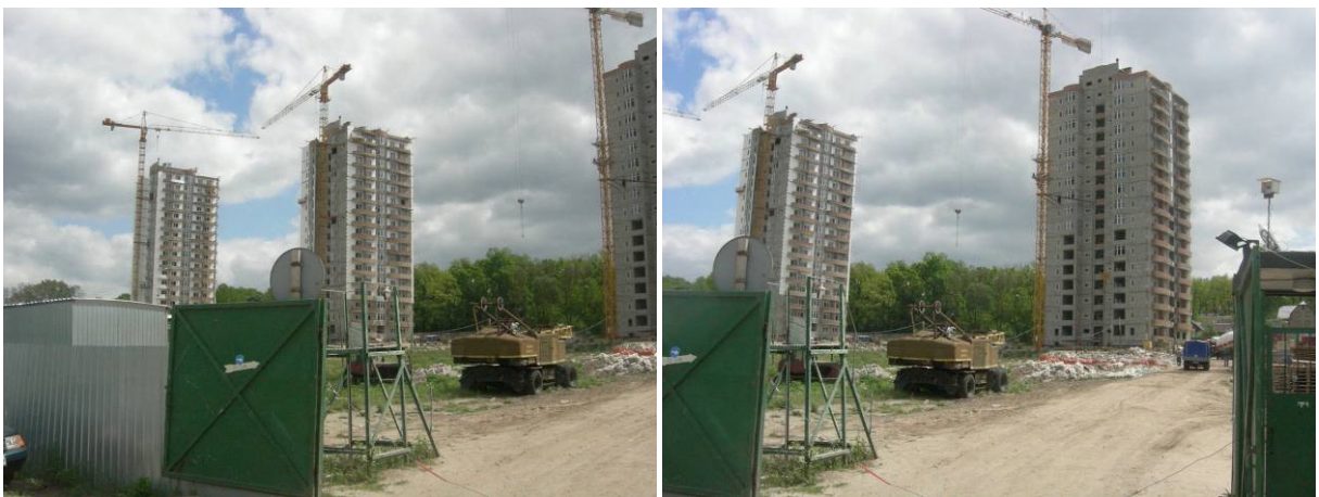
Стан будівництва житлового комплексу Grand Life в м. Ірпені Київської області станом на 18.05.2009 р.
