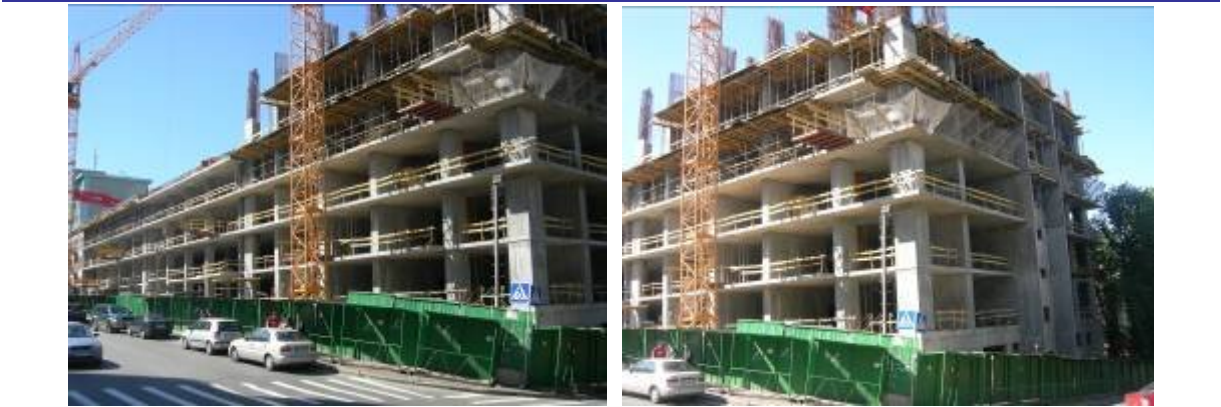
Рисунок 1.2. Будівельні роботи на об'єкті будівництва, обмеженого вулицями Предславинською, Ульянович та Червоноармійською станом на 04.06.2009 р.
