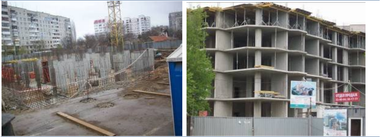
Хід робіт на об'єкті будівництва по вул. Малиновського (на розі вул. Заводської та пров. Союзного) в м. Одесі станом (зліва - направо) на середину лютого 2009 р. та на кінець травня 2009 р.
