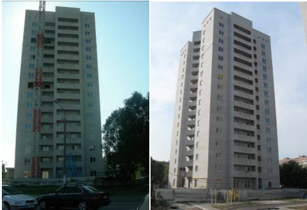
Об'єкт будівництва в районі вулиць Космічної та Мандриківської, м. Дніпропетровськ (друга черги) станом: (зліва-направо): на кінець травня 2009 року та на вересень 2009 року
