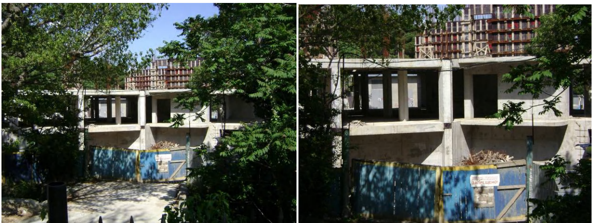
Хід будівництва рекреаційного комплексу по вул. Луговського в смт. Сімеїз станом на 04.06.2009 р.
