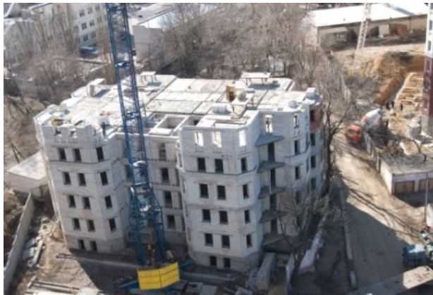
Рисунок 2. Стан будівництва по вул. Хантадзе, 7 Б у м. Іллічівську станом на березень 2010 року
