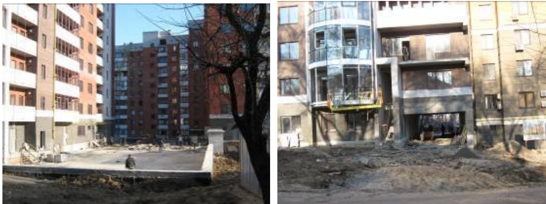
Хід робіт на об'єкті будівництва по вул. Херсонській (будинок та паркінг), у районі буд. № 9 А, станом на кінець лютого 2009 року
