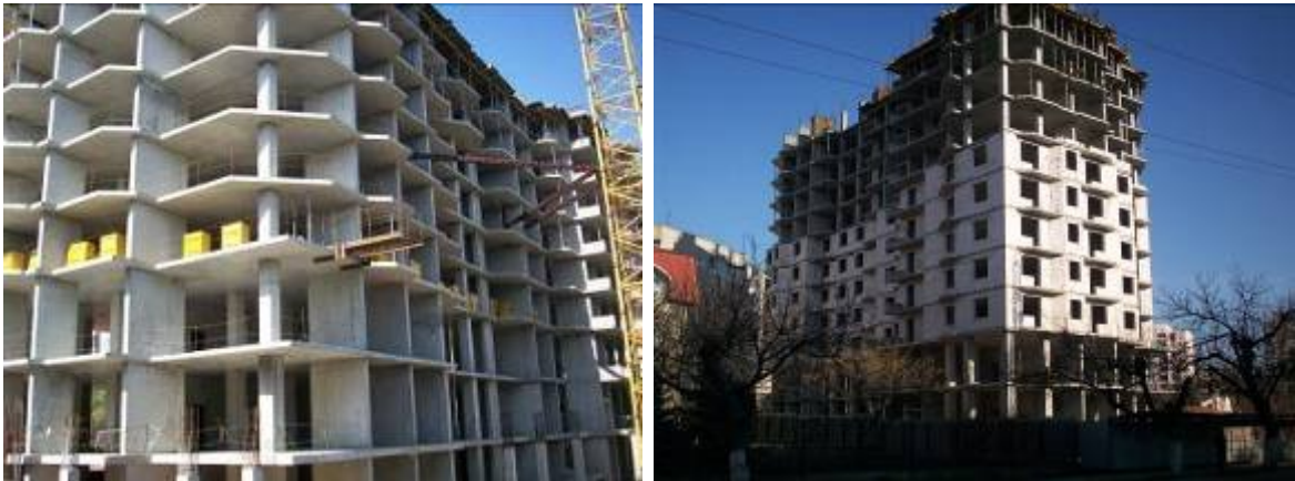
Хід робіт на об'єкті будівництва по вул. Малиновського (на розі вул. Заводської та пров. Союзного) в м. Одесі станом на початок вересня 2009 р. та на кінець листопада 2009 р.
