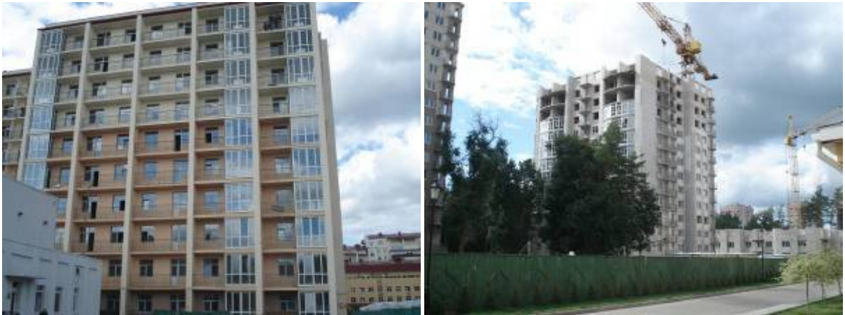
Будівництво житлового комплексу (II черга) в Київській області с. Чайки по вул. Лобановського, 1 станом на 01.08.2009 р.
