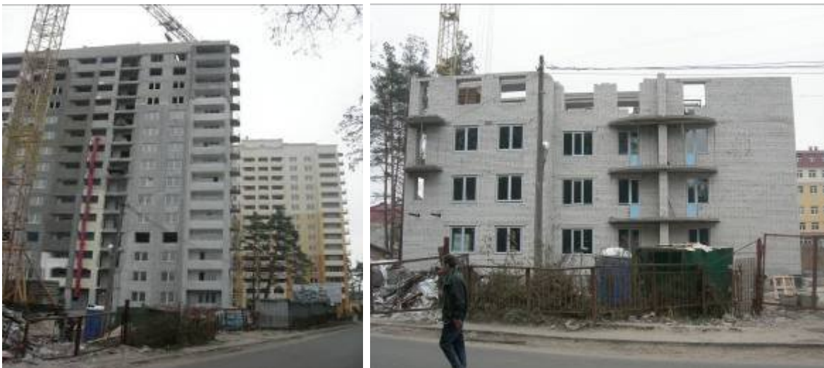
Будівництво житлового комплексу (II черга) в Київській області с. Чайки по вул. Лобановського, 1 станом на середину листопада 2009 р
