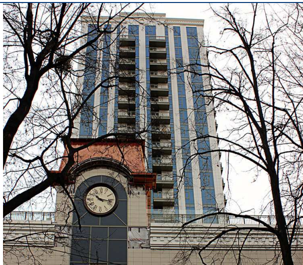
Хід будівництва житлово-офісного комплексу по вул. Воровського, 21 у м. Києві станом на кінець жовтня 2016 року
