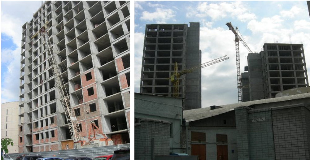
Хід робіт на об'єкті будівництва по пров. Ламаному в м. Дніпропетровську станом на початок червня 2010 року
