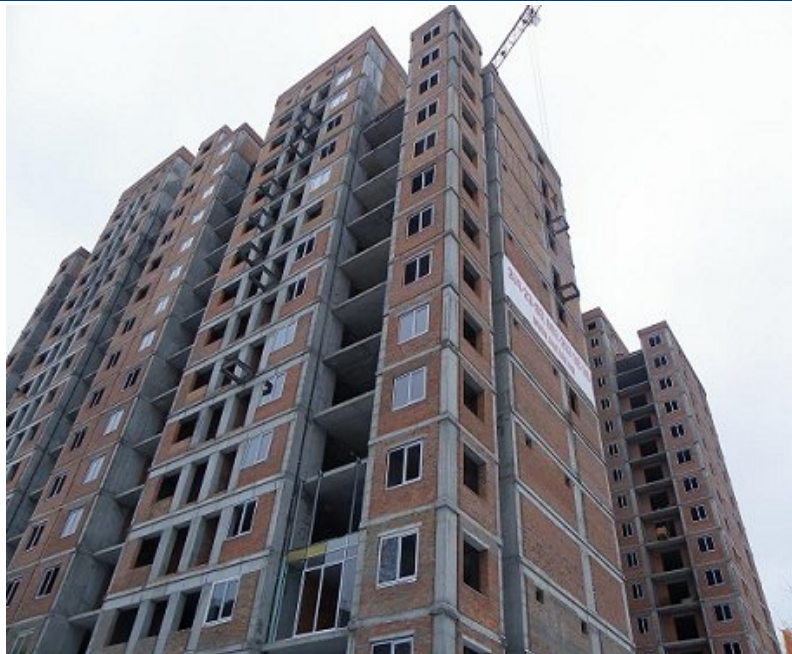
Хід робіт на об'єкті будівництва по пров. Ламаному в м. Дніпропетровську станом на 13.12.2010 р.
