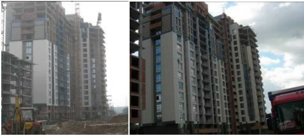
Хід робіт з будівництва ж/б 3 по вул. Професора Підвисоцького у Печерському районі м. Києва станом (зліва-направо): на 12.03.2009 р. та на 18.06.2009 р.
