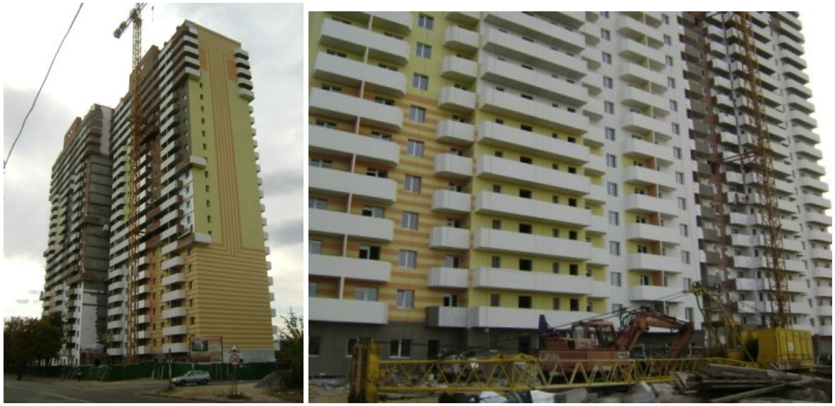
Рисунок 1. Будівельні роботи на об'єкті будівництва в м. Києві по вул. Генерала Наумова, 66 станом на 10.08.2009 р.
