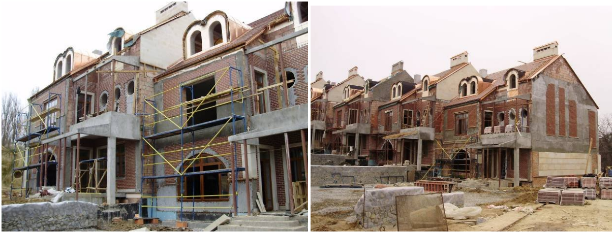
Рисунок 1.1. Будівництво багатофункціонального торговельно-розважального комплексу з сервісними службами та індивідуальною житловою забудовою на вул. Метрологічній, 18 у м. Києві станом на кінець 2008 р.
