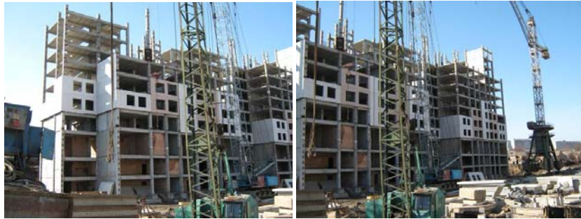
Будівельні роботи на об'єкті будівництва «Нова Перемога» у м. Дніпропетровську станом на 20.02.2009 р.
