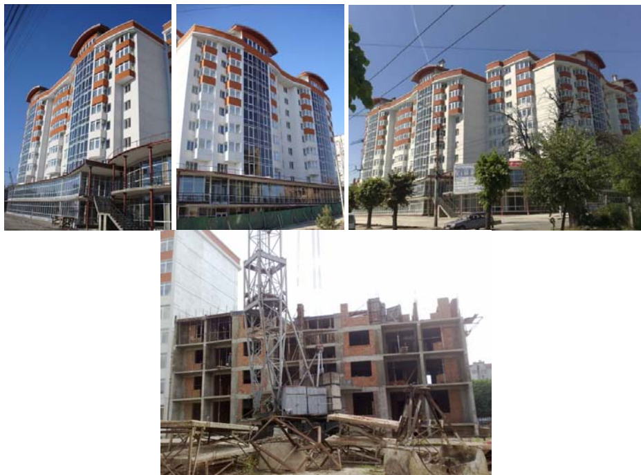
Будівництво житлового комплексу у м. Чернівцях по вул. Руській, 219 (будинки №№ 5 та 6 -зверху, будинок №4 - знизу) станом на середину липня 2009 року
