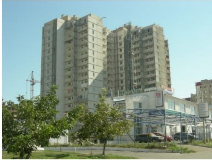
Рисунок 1. Стан будівельної готовності житлових будинків № 1 та № 1А у мікрорайоні III-4-1 Котовського у м. Одесі станом на 27.08.2010 р.
