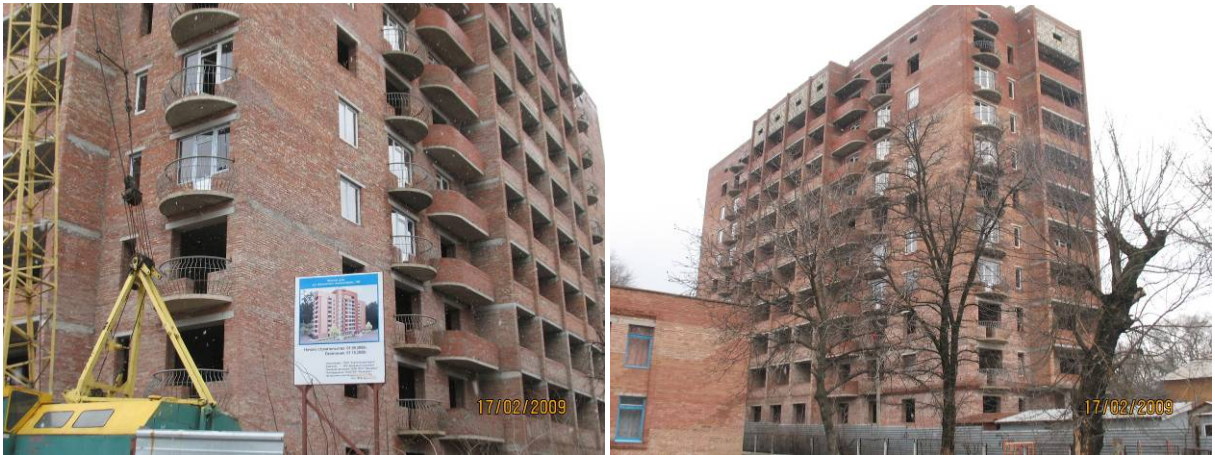
Стан будівництва житлового будинку по вул. Бакинських Комісарів, 100 у м. Донецьку станом на 17.02.2009 р.
