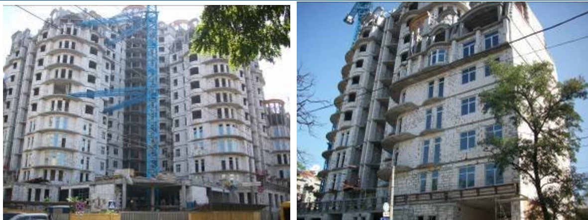
Будівельні роботи на об'єкті будівництва офісно-житлового комплексу по вул. Канатній, 27 станом на початок вересня 2009 р.
