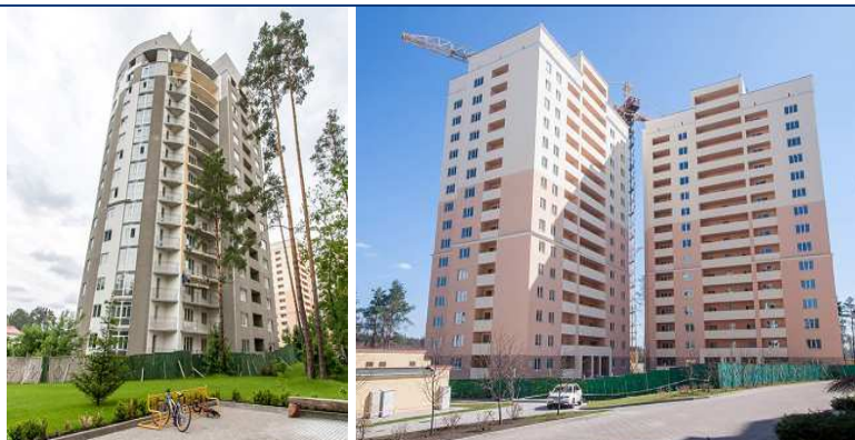
Будівництво житлового комплексу (II черга) по вул. Лобановського, 1 у с. Чайці Києво-Святошинського району Київської області станом на кінець травня 2013 року (зліва направо: будинок №8, будинок №9)
