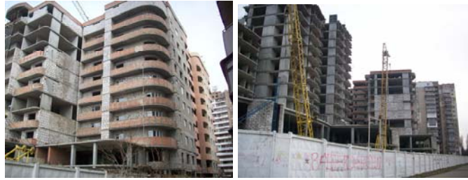
Стан будівництва громадсько-житлового комплексу у мікрорайоні ім. Таїрова на розі вул. 25-ї Чапаївської дивізії та просп. Маршала Жукова у м. Одесі на 20.01.2009 р.
