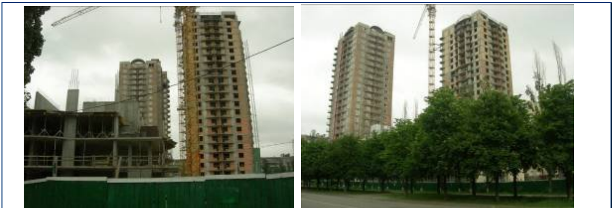
Будівельні роботи по житловим будинкам №№ 33 та 34 та № 35 станом на кінець травня 2010 року
