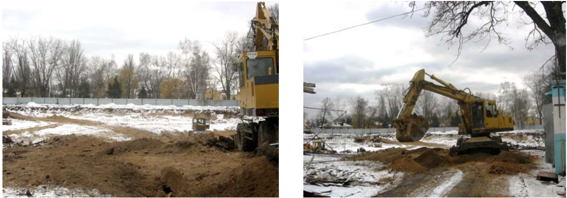
Рисунок 2.3. Хід робіт на об'єкті будівництва по вул. Б. Вишневецького, 70 (буд. номер №78) у м. Черкасах станом на 29.01.2008 р.
