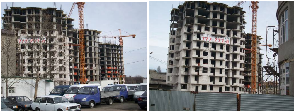
Житловий комплекс по вул. Артилерійській, 4 у м. Одесі на середину лютого 2009 року
