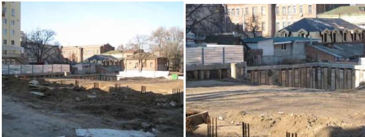
Хід робіт на об'єкті будівництва по вул. Шевченка у м. Дніпропетровську в 2009 році
