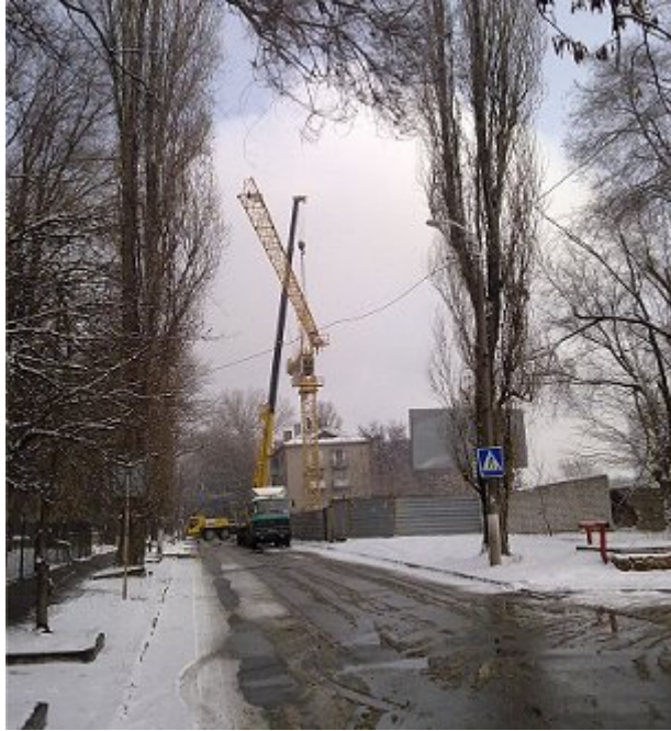
Будівництво житлового будинку по вул. Фурманова, 11 у м. Дніпропетровськ, станом на середину лютого 2012 року
