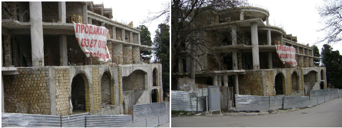
Рисунок Ошибка! Текст указанного стиля в документе отсутствует.. Стан будівництва рекреаційного комплексу по вул. Дворцове шосе, 3 у м. Алуці станом на 05.03.2010 р.
