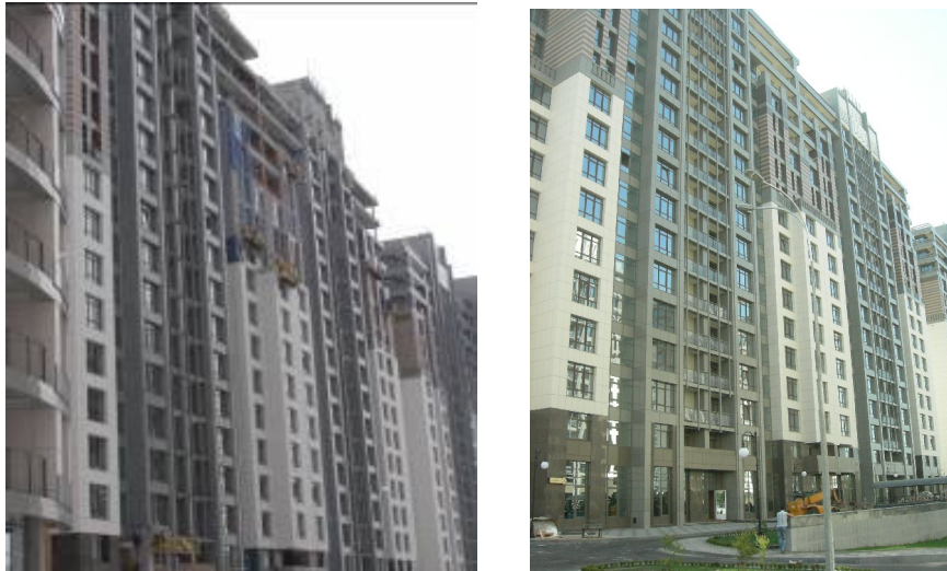
Хід робіт з будівництва ж/б 2 по вул. Професора Підвисоцького у Печерському районі м. Києва станом (зліва-направо): на 18.03.2010 р. та на 08.06.2010 р.
