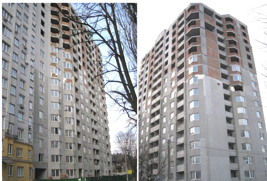
Будівництво житлового будинку по вул. Краснова, 19, Святошинський район м. Києва, станом на 01.05.2009 р.
