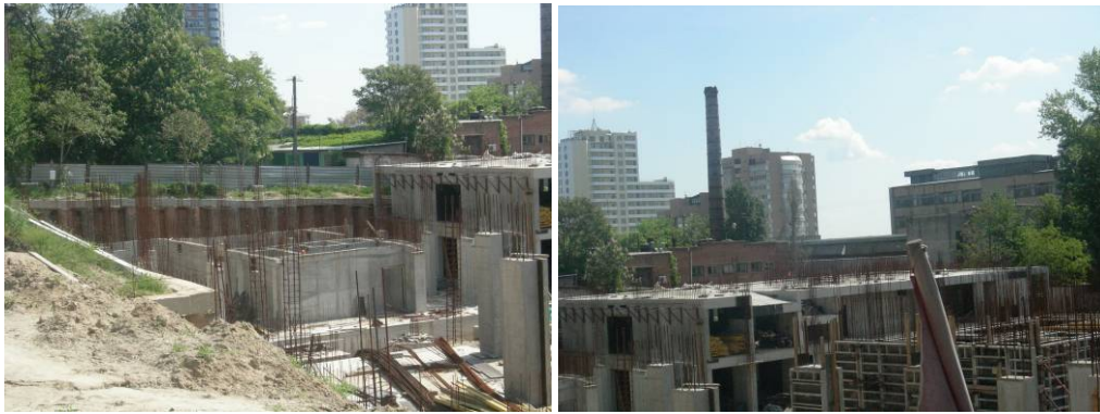
Будівництво житлового будинку по вул. Фурманова, 11 у м. Дніпропетровськ станом на кінець травня 2009 року
