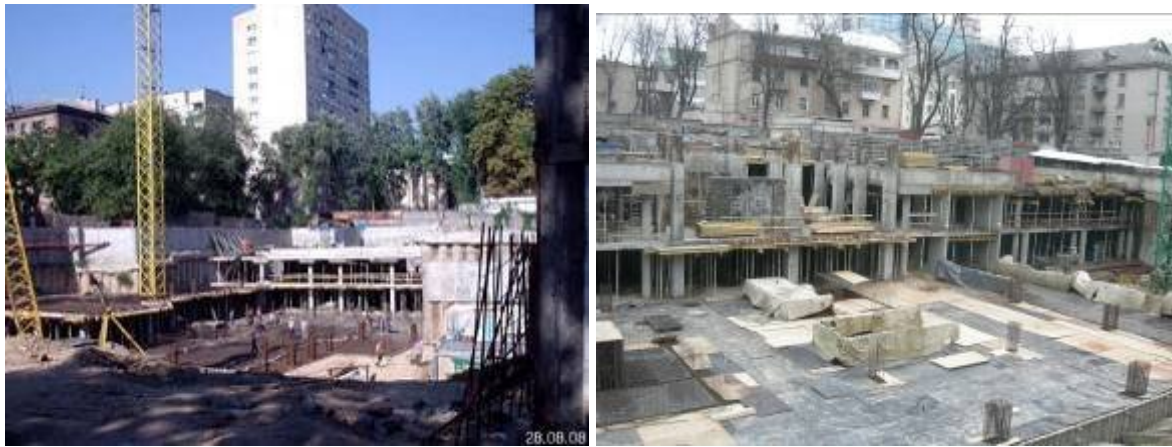
Хід робіт з будівництва багатоповерхового житлового будинку з вбудовано-прибудованими приміщеннями громадського призначення та підземного паркінгу по вул. Білоруській, 36-а у Шевченківському районі м. Києва станом на кінець серпня 2008 року та на початок грудня 2008 року
