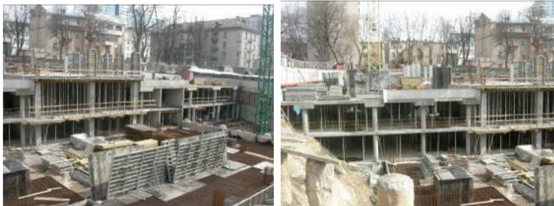
Хід робіт з будівництва багатоповерхового житлового будинку з вбудовано-прибудованими приміщеннями громадського призначення та підземного паркінгу по вул. Білоруській, 36-а у Шевченківському районі м. Києва станом на кінець березня 2009 року
