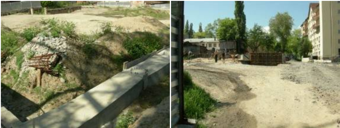
Рисунок 2. Хід робіт на об'єкті будівництва по вул. Шевченка у м. Дніпропетровську в 2010 році
