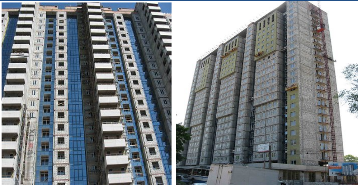
Хід робіт на об'єкті будівництва по вул. Ульянова, в районі буд. 17 А у м. Дніпропетровську станом на 20.05.2009 р.
