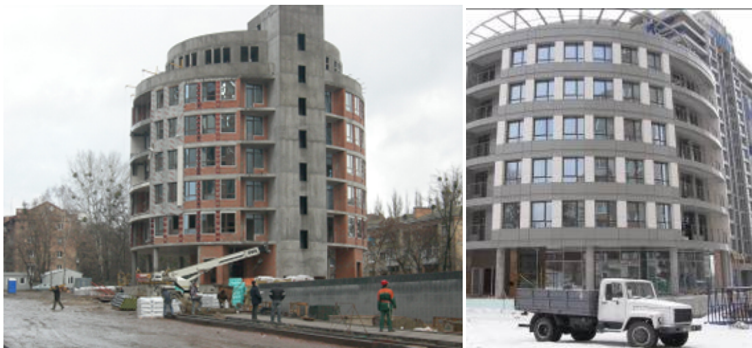
Хід робіт з будівництва ж/б 1 по вул. Професора Підвисоцького у Печерському районі м. Києва станом (зліва-направо): на 19.11.2009 р. та на 18.03.2010 р.
