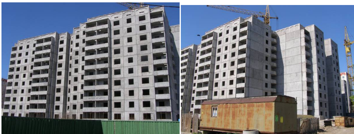
Будівництво житлового будинку по вул. Ватутіна, 97 у м. Борисполі станом на 14.05.2009 р.
