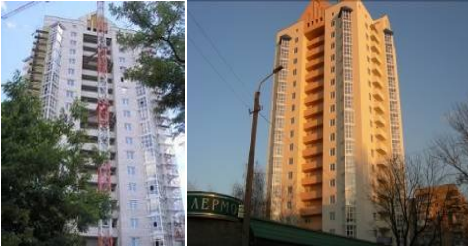
Об'єкт по проспекту газети «Правда» в районі будинку №16, м. Дніпропетровськ станом на 23.06.2008 р. та станом на кінець листопада 2008 року
