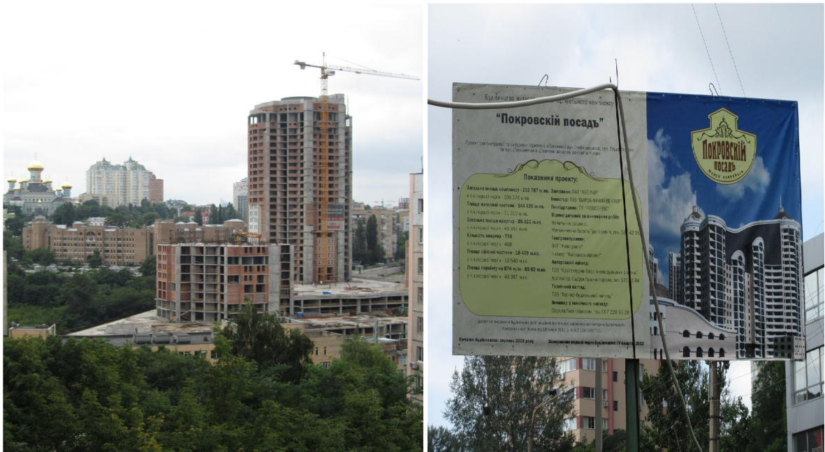
Рисунок 1. Будівельні роботи на об'єкті будівництва офісно-житлового комплексу в м. Києві на ділянці, обмеженої вулицями Глибочицькою, Студентською та Пимоненка станом на початок серпня 2011 року
