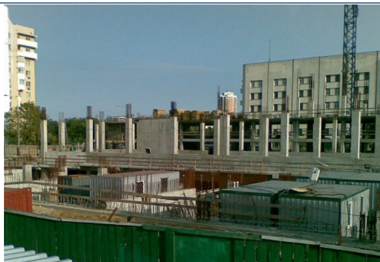
Стан будівництва офісної будівлі за адресою: м. Київ, пров. Індустріальний ,1-А на 29.08.2009 р.
